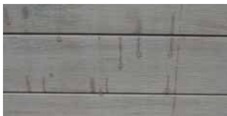
Formation de taches due à des particules révélées par la pluie
