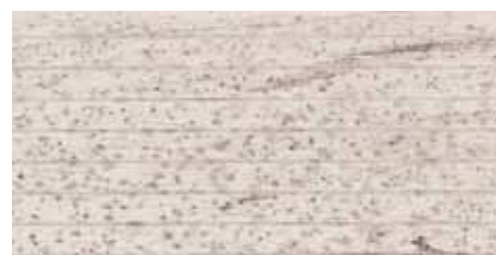
Taches de moisissure/champignons à la surface
